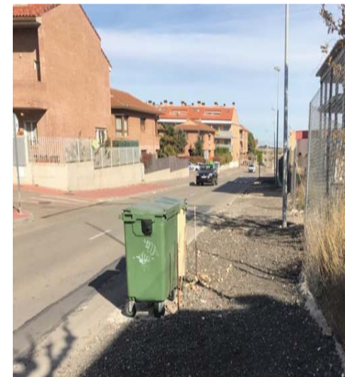
Acerado incompleto, frente a la entrada del instituto, polideportivo.
